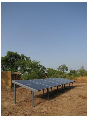
Les panneaux solaires
