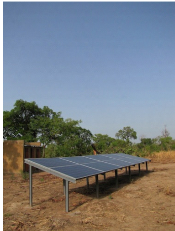
Les panneaux solaires
