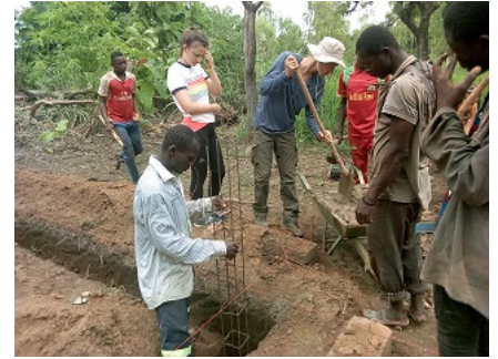
étudiants de l'école Centrale de Nantes et élèves d'Agrithèque travaillant aux fondations.
